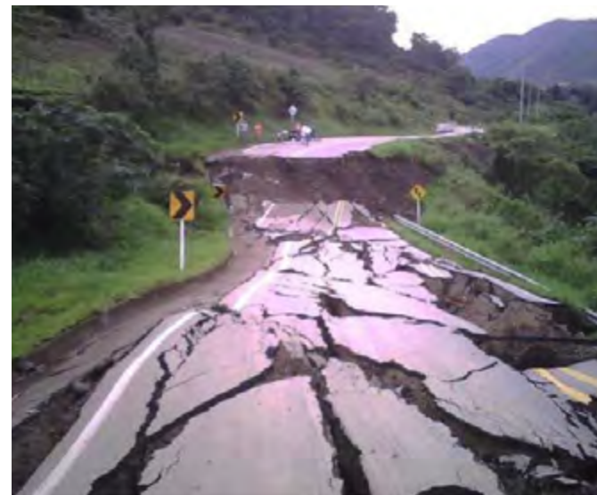
Figura 2. Daño causado a la Vía Cúcuta – Pamplona por el fenómeno de La Niña 2010/2011
