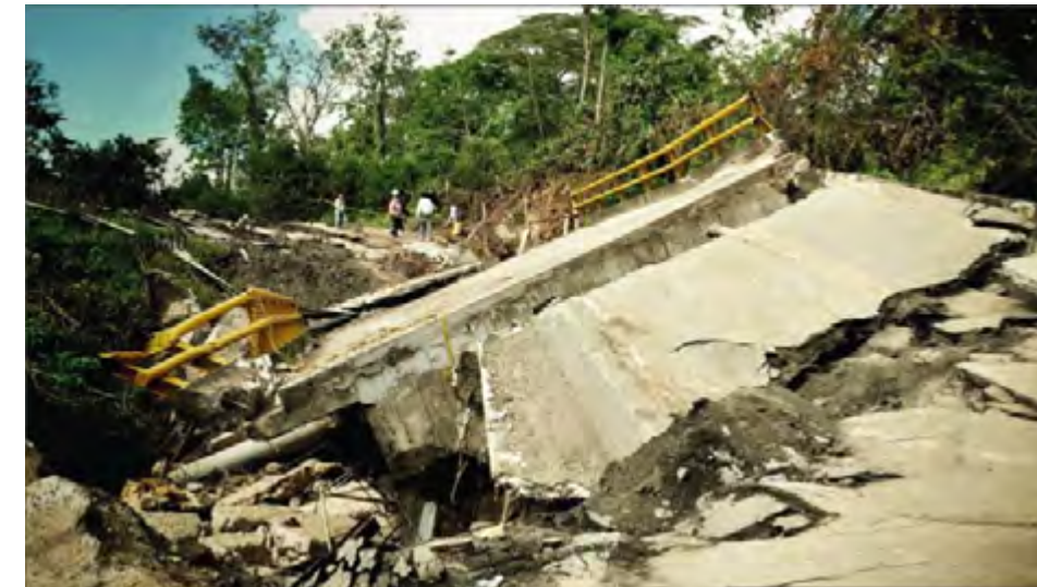
Figura 3. Daño causado a la Vía Bucaramanga – Barrancabermeja por el fenómeno de La Niña 2010/2011
