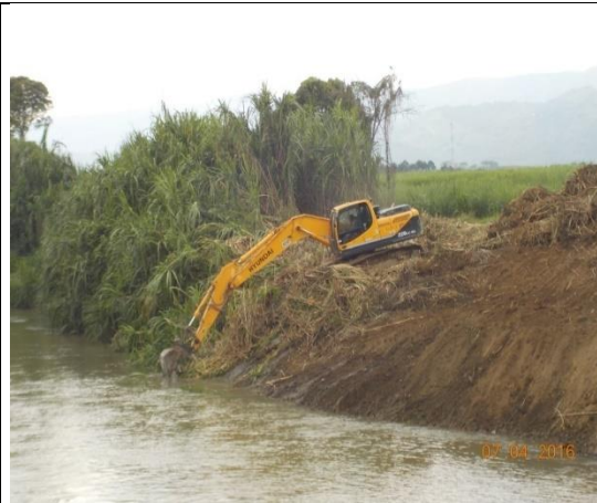
PR 145+570 - PR 145+660, descapote y retiro de material sobrante en el área de construcción del puente sobre el Río Risaralda.
