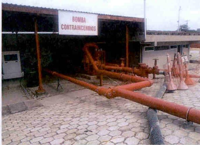
Foto 6. Caseta del sistema contraincendios.
