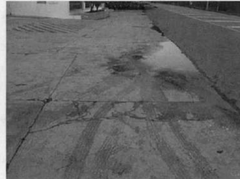
Foto 10. Deficiencias pavimento rígido
