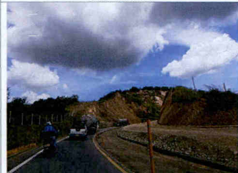
Foto 32. Paso a un solo carril, intervenciones en la margen derecha de la vía.
