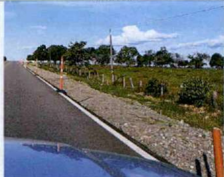
Foto 20. Crecimiento de vegetación en excavaciones de ampliación.
