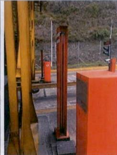
Foto 28. Dispositivos de detección y clasificación de vehículos en el peaje La Pasión.
