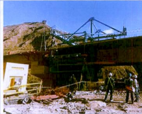
Foto 23. Unión de sistemas de vigas y dovelas sucesivas sobre uno de los apoyos del puente.
