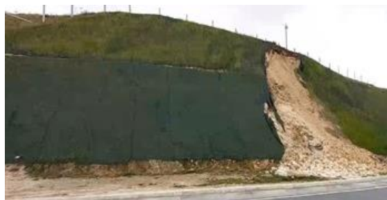
Foto 6. PR68+000: Erosión en talud de corte
