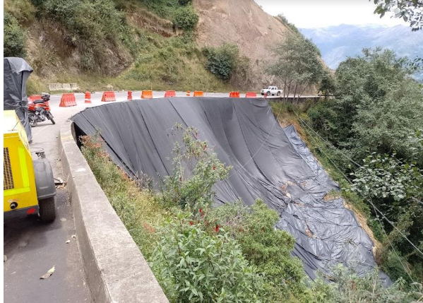
Foto 29. Sitio inestable PR105+500.
