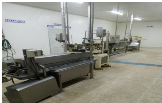
Foto 2. Equipos al interior de la terminal
